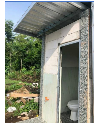
農場水洗トイレ1棟
